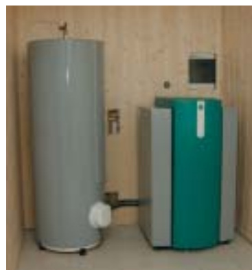
L'encombrement d'une pompe à chaleur et de son ballon d'eau chaude sont analogues à ceux d'une installation de chauffage classique avec chaudière.
